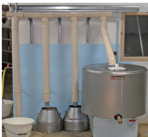
Séparation des laits à la sortie du robot
